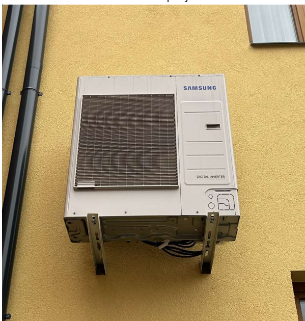
Obrázek č. 2.6.11: Klimatizační split jednotka
